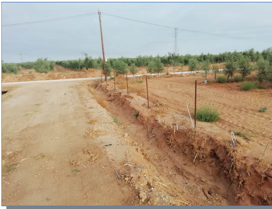
Figura 18. Camino y cuneta junto a plantación de olivar en parcela 6 del polígono 20 de Bollullos de la Mitación. Se identifican restos de la erosión generada en la última avenida del arroyo innominado existente
